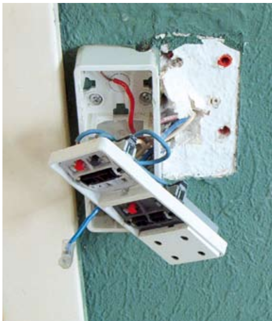
Elarbejde, som er ulovligt udført. (Misligholdelse – uforsvarlig adfærd)
