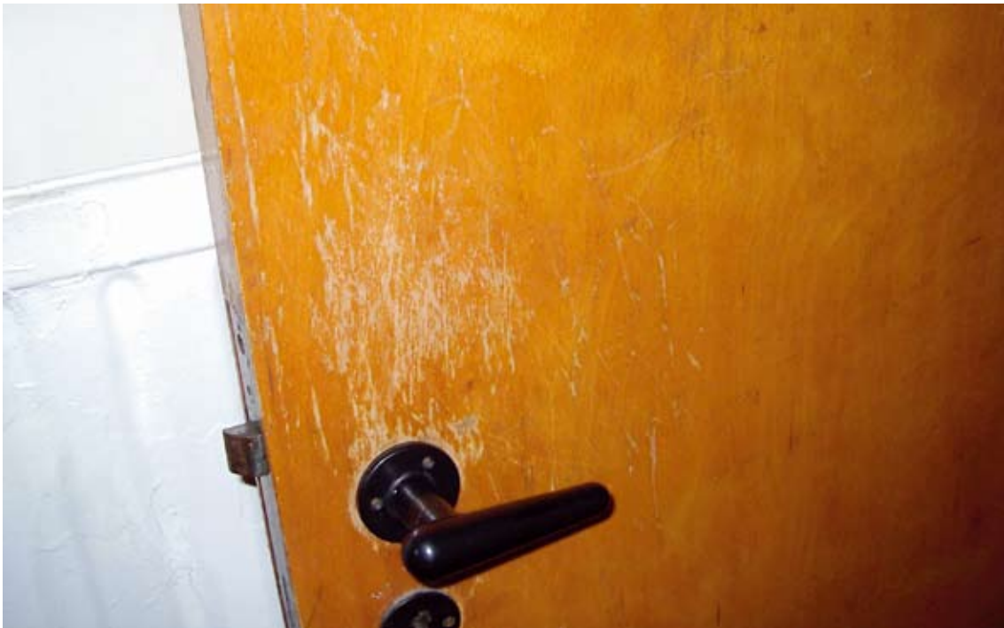
Kradsemærker på dør. (Misligholdelse)
